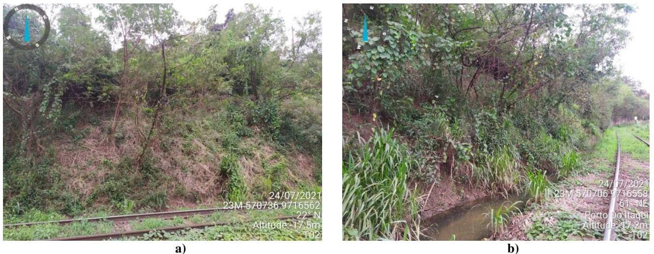
Figura 4: Talude 02 com drenagens obstruídas por vegetação
